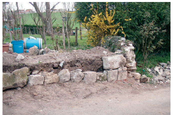
Consolidation extérieure pour protéger l'avant de la voûte encore visible sur 1,50 m environ.
